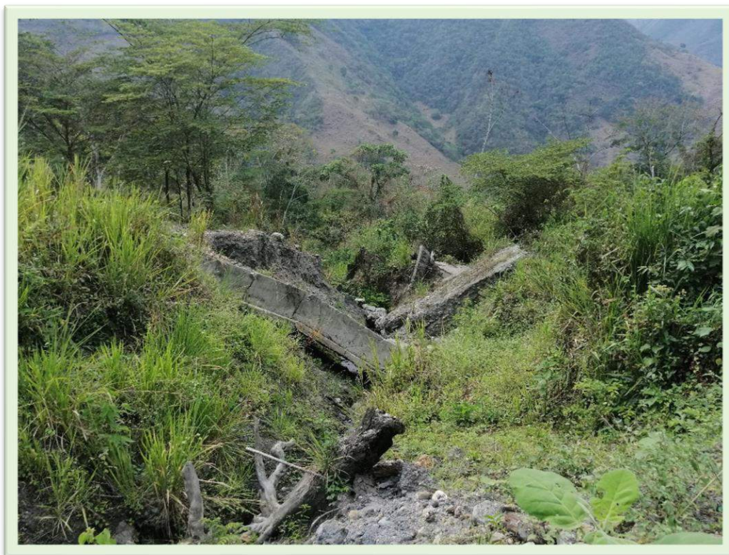
Imagen 6. Falla geológica vereda El Río. Vía que comunica el casco urbano con los corregimientos del municipio
